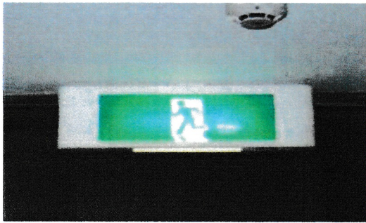
避難口誘導灯
