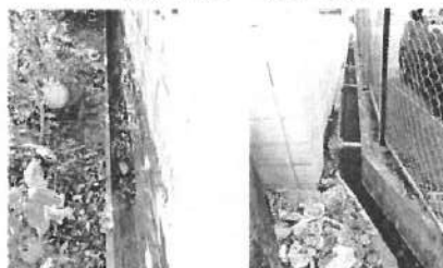
自治会館排水不良 小谷建設掘建設の残滓で排水不良(1月)
