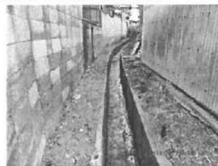
多治井174付近除草 灌木・草繁茂下水道局除草依頼(8月)
